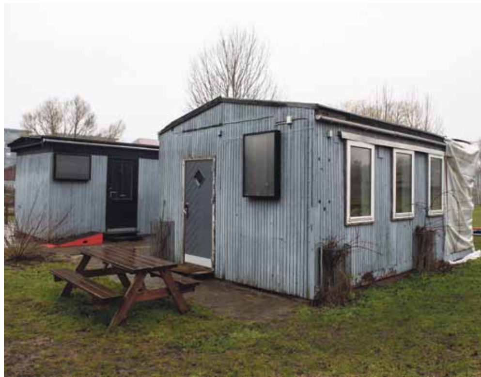
I 1993 blev naturfritidshjemmet opført på Fritidscenter Islands Brygges udeareal. Men efter godt 25 års tro tjeneste, var bygningerne så slidte, at de måtte lukkes og siden rives ned.
